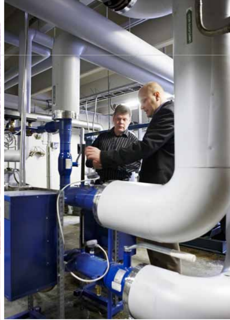
Mitoxin ja HelenLämmön yhteistyö on sujuvaa ja työnjako selkeää. Mitoxin Juhani Halttunen (vas.) ja HelenLämmön Pekka Takki tarkastelevat kaukolämmön lämmönjakokeskusta.
